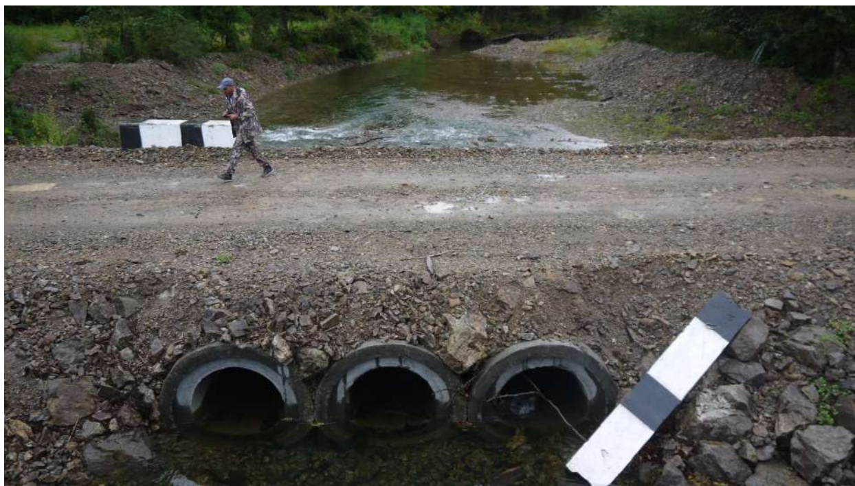
Фото 2 Водопрпускные трубы в русле реки Лиственная на временном объезде (вид с аварийного моста вниз по течению)
