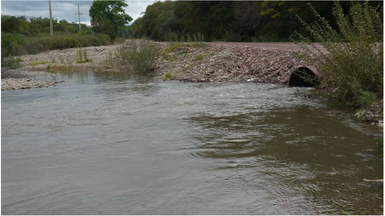
Фото 24 Временная водопропускная труба на участке размыва автодороги Маргаритово - Моряк-Рыболов на 3км (вид с верховой стороны)
